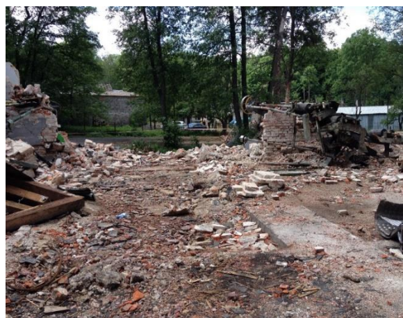
Fot 5 Miejsce wypadku
