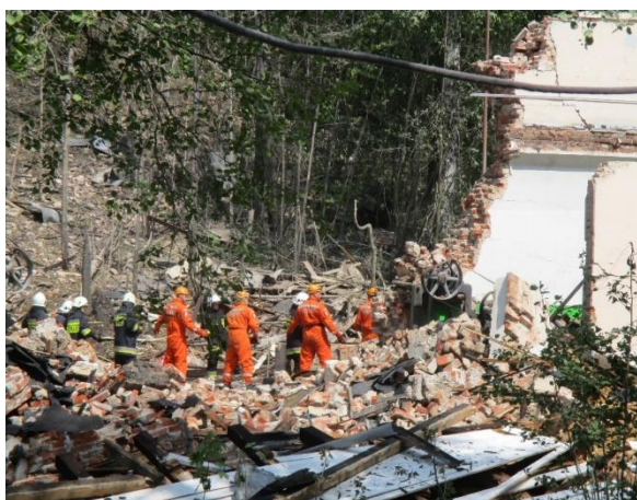
Fot 4 Miejsce wypadku
