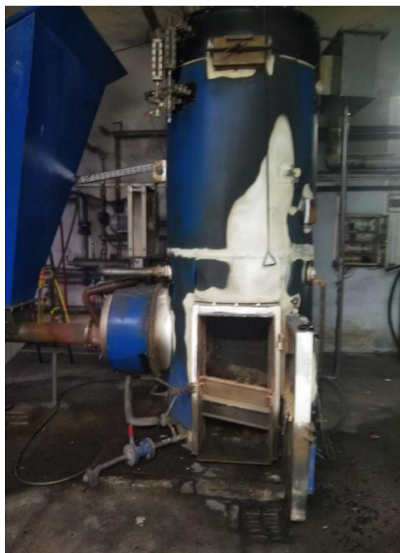
Fot. 6 Widok uszkodzonego kotła
